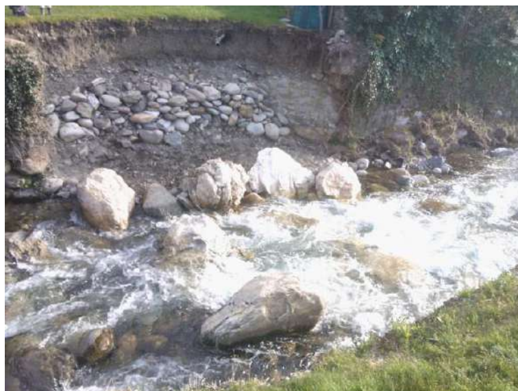
Rive gauche effondrée
